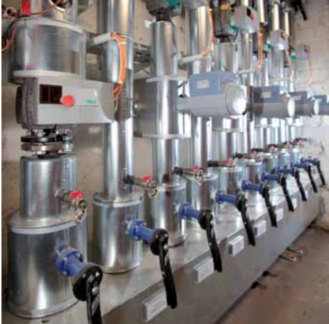
Über BACnet eingebundene Hocheffizienz-Heizungspumpen. High-efficiency heating pumps integrated via BACnet.
